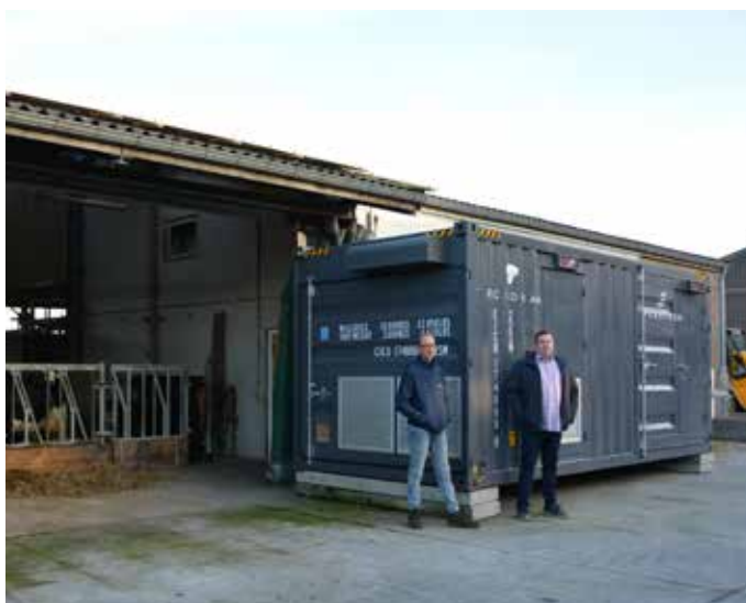
Bert Gielen (links) en Frank Vandijck (Posetron) bij de container met batterijopslag. Bert: “Via deze investering brengen wij onze energieprijzen onder de 1 cent per liter melk per jaar en dat voor 20 jaar.”
